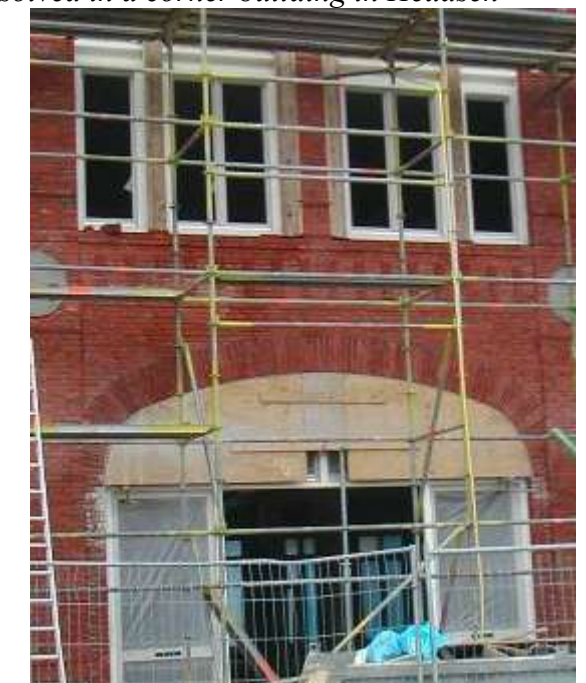
Quello che avrebbe voluto essere un arco ellittico in un edificio di Brandevoort: essendo sbagliata in partenza la sagoma della centina, anche la disposizione dei mattoni risulta assurda e spigolosa – What they intended to be an elliptical arc in a building Brandevoort: the shape of the rib is incorrect, with even the arrangement of the bricks absurd and angular
